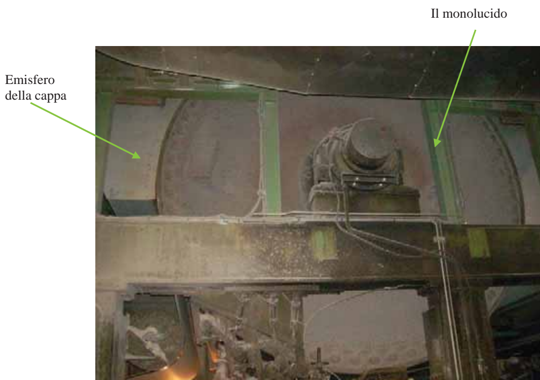
Fig. 11 – Foto della cappa installata sul monolucido della RDM
