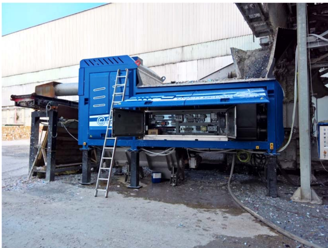
Vista laterale Tiger Depack installata nello stabilimento RDM di Santa Giustina (BL)
