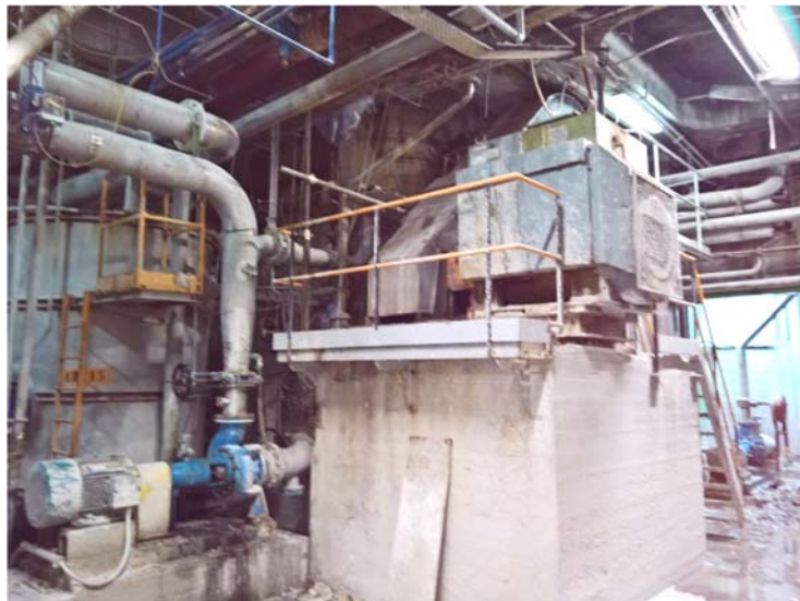
Motore girante Pulper (alto a destra) con relativa tubazione e pompa accettato (basso sinistra)
