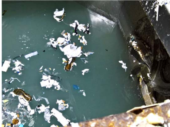
Interno del Pulper fermo, con particolare attenzione alla girante e alla griglia forata posta dietro di essa, si noti la residua presenza di scarto plastico affiorante in superficie
