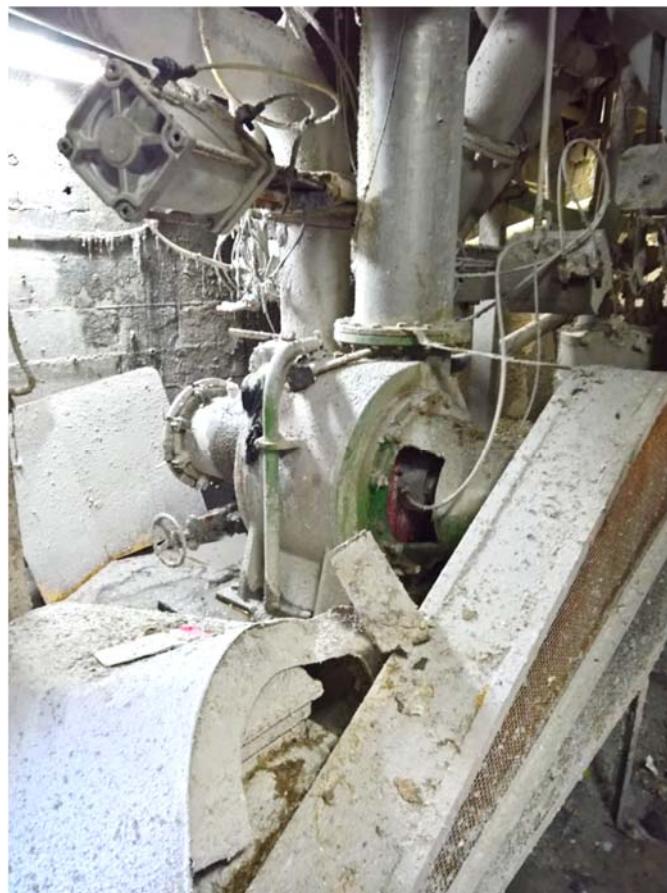
Pompa CE02, in evidenza i 2 ingressi con valvole temporizzate, in particolare tubo acqua CE05 (sinistra), tubo prelievo Pulper (destra)
