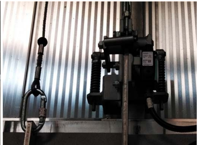
Dispositivo blocco di sicurezza sulle saracinesche.
