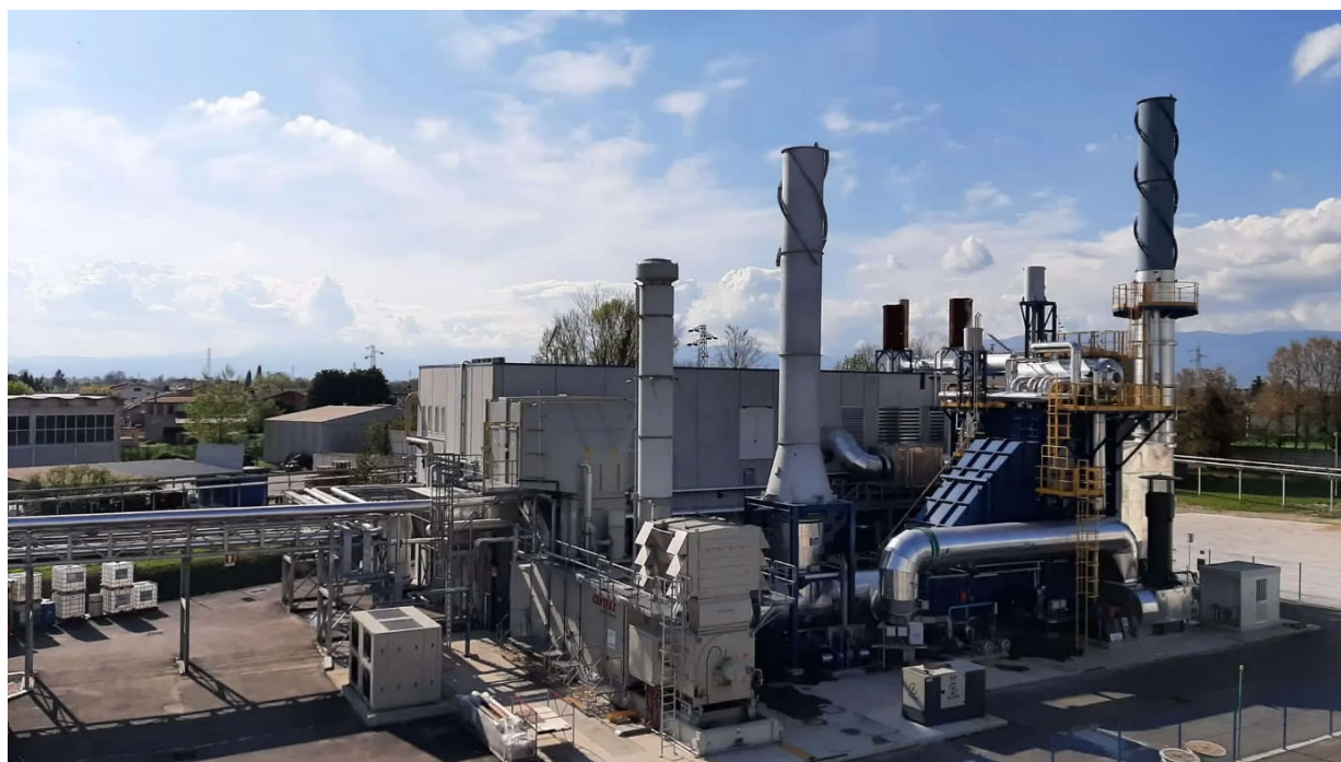
Nuovo impianto di cogenerazione (2022).
