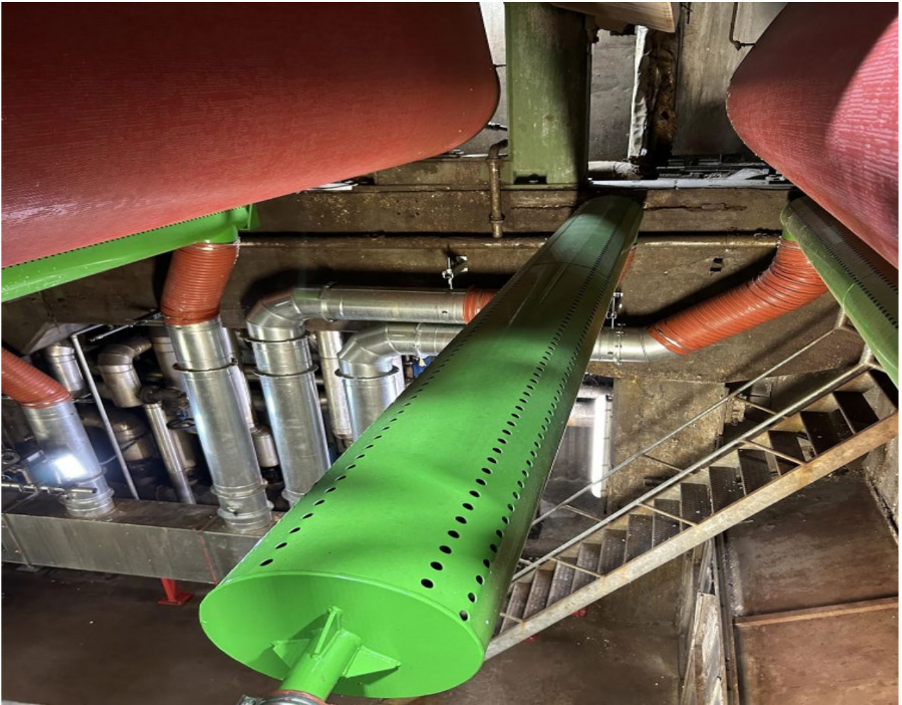
Immagine 2: tubo di ventilazione (verde) posto sotto la pre seccheria
