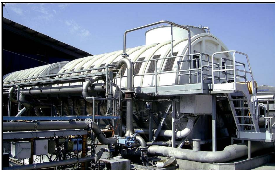
Fig. 4.1 CBR presso lo stabilimento di Sarego
