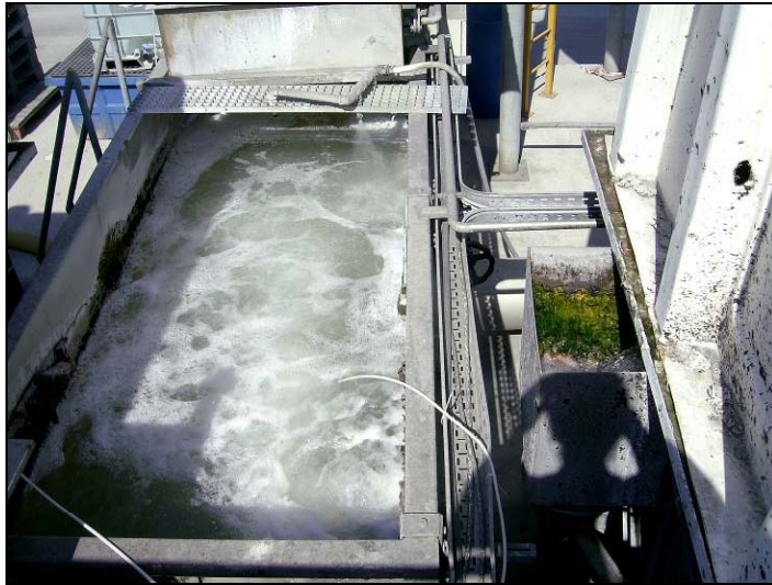
Fig. 4.9 Vasca di scarico dei biofiltri, acqua prima di essere convogliata nel discfilter
